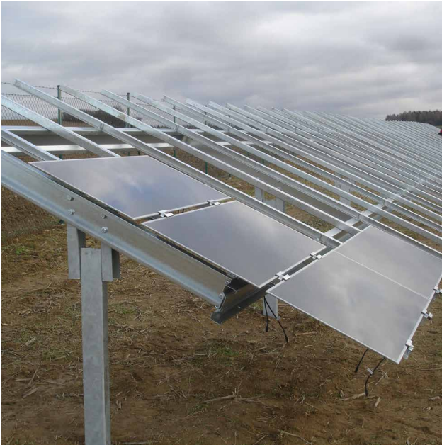
Pfetten-Konstruktion in Kombination mit Solarzellen.
