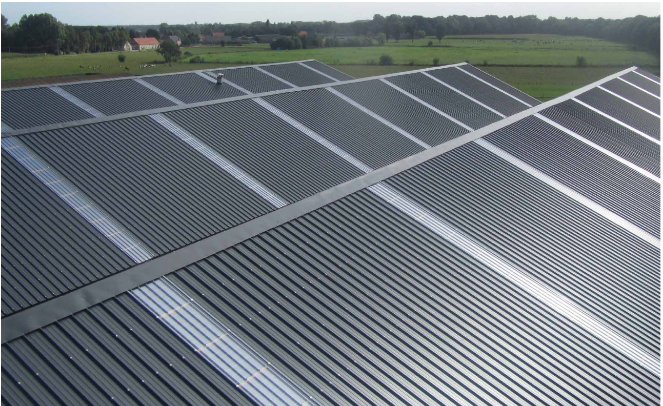
Industrielle Realisierung mit JI 45-333-1000 und Lichtplatten.
