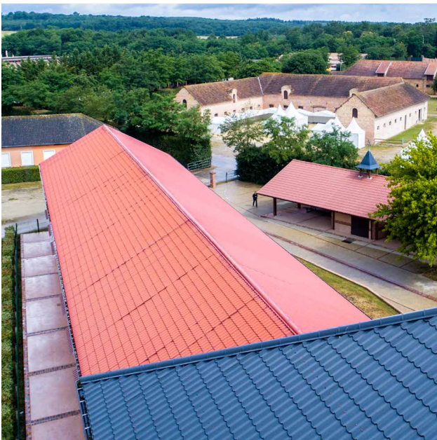
Gebäude des französischen Reiterverbandes mit JI Permapan PIR.
